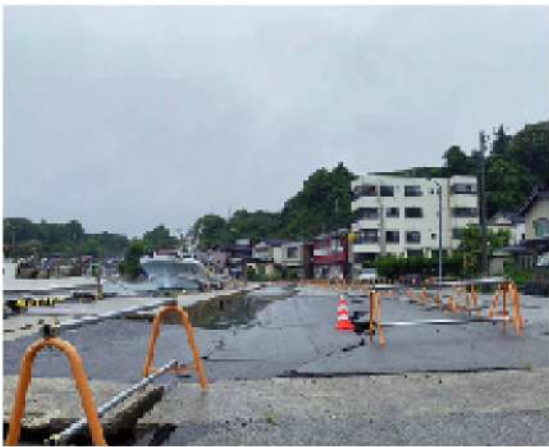
ひび割れて傾きの残る道路
